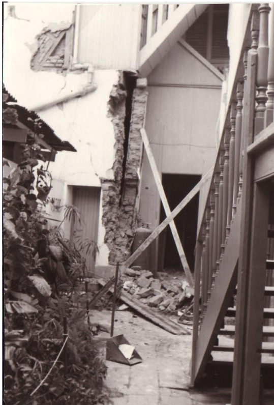
Skader på Cristiania etter jordskjelvet i 1974. Fra strandpromenaden og inne i patioen.
